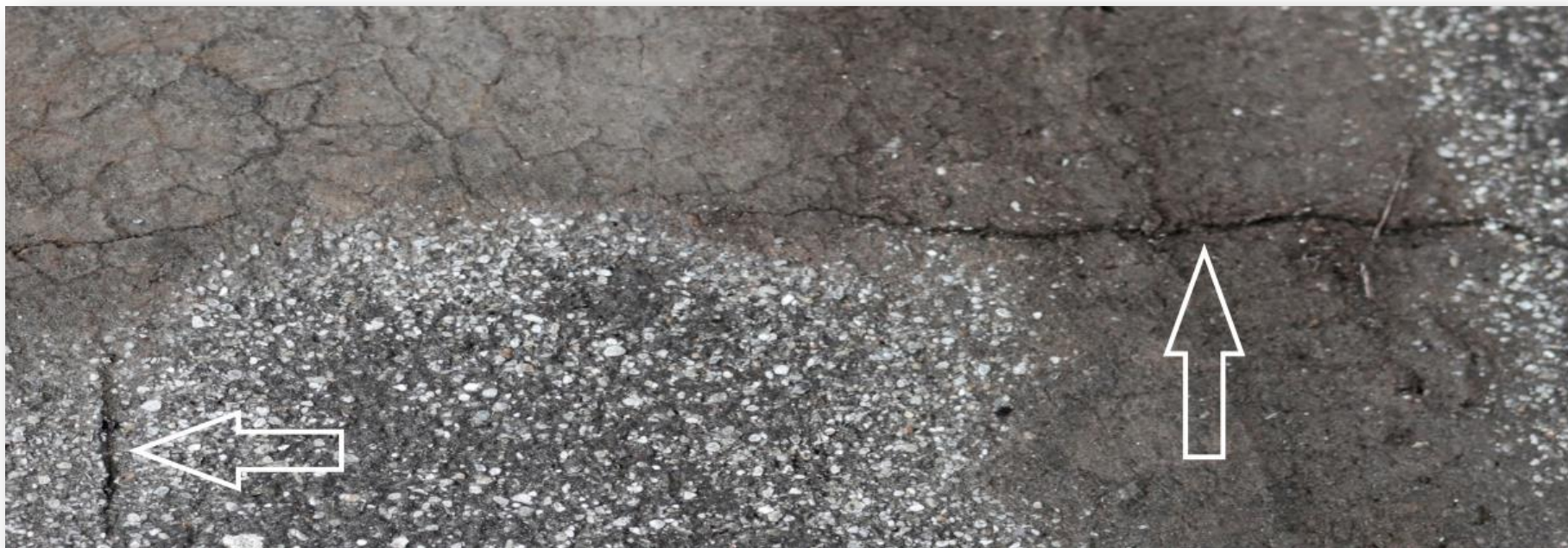
Zdj.3 - pęknięcia starej powłoki hydroizolacji oraz podłoża
